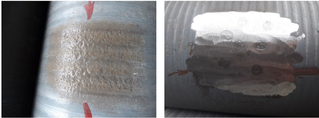
в) Локална корозия след общо шлайфане на защитния слой и след шлайфане за целите на дебелометрия;
