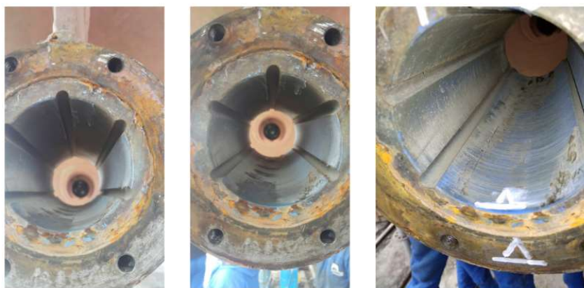
Фиг. 6. Износване в лагера на кронщейна
